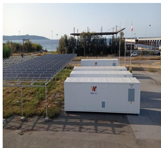
Figura 2 – Unidades de Energia Remota (RPU) já instaladas pelo projeto em 13 aldeias
