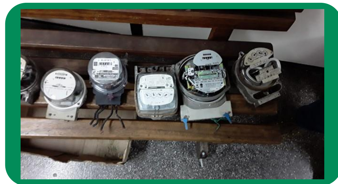
Medidores Recuperados e prisão do receptor
